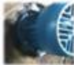
WEG Motor Scan instalado
